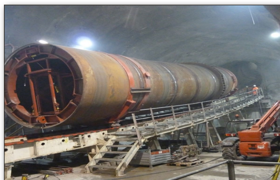
Druckrohrleitung für Pumpspeicherwerk in Limmern, Schweiz Bildquelle: DSD NOELL
